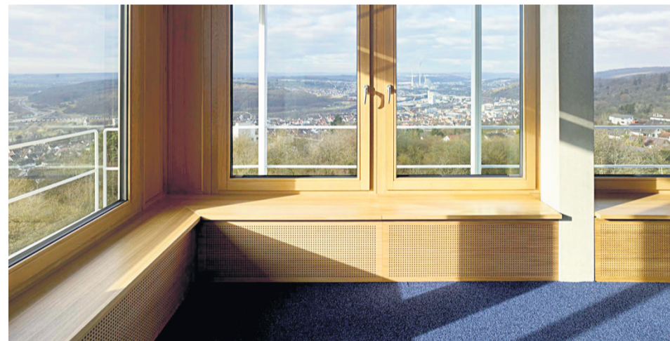
Arbeiten mit Aussicht aufs Neckartal: Hinter der feinen Holzverkleidung verbirgt sich viel Technik, die sonst in der Decke stecken müsste.
