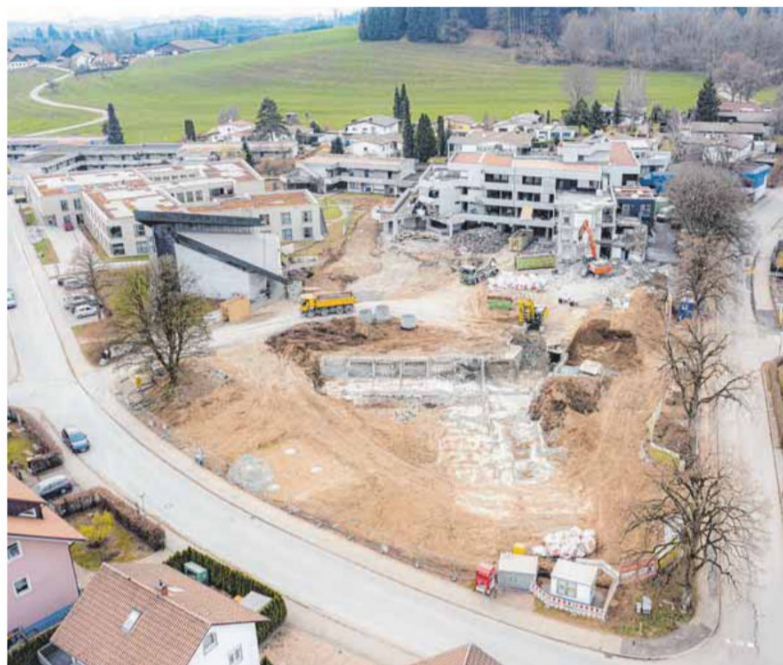
Derzeit wird auf der Baustelle des früheren Seniorenzentrums von St. Vinzenz das Hauptgebäude entkernt und abgerissen. Links sind Kirche und neues Pflegeheim zu sehen.
